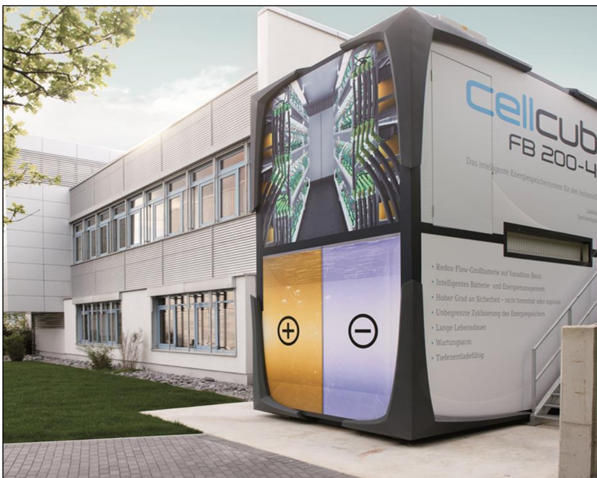
Obrázek 12: Instalace 260 kW vanadium-redoxového bateriového systému v Bielefeldu v Německu.
