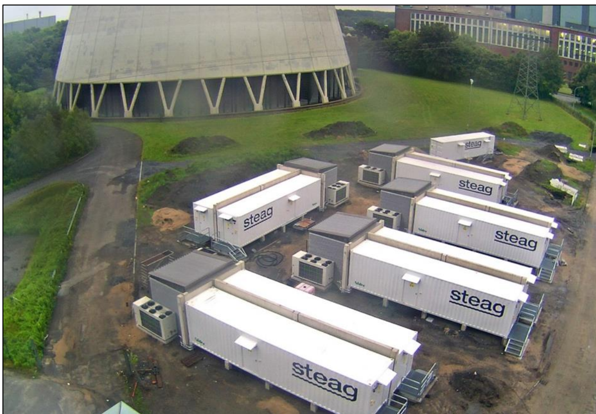
Obrázek 9: Instalace 15 MW lithium-iontového bateriového systému na elektrárně ve městě Lünen.
