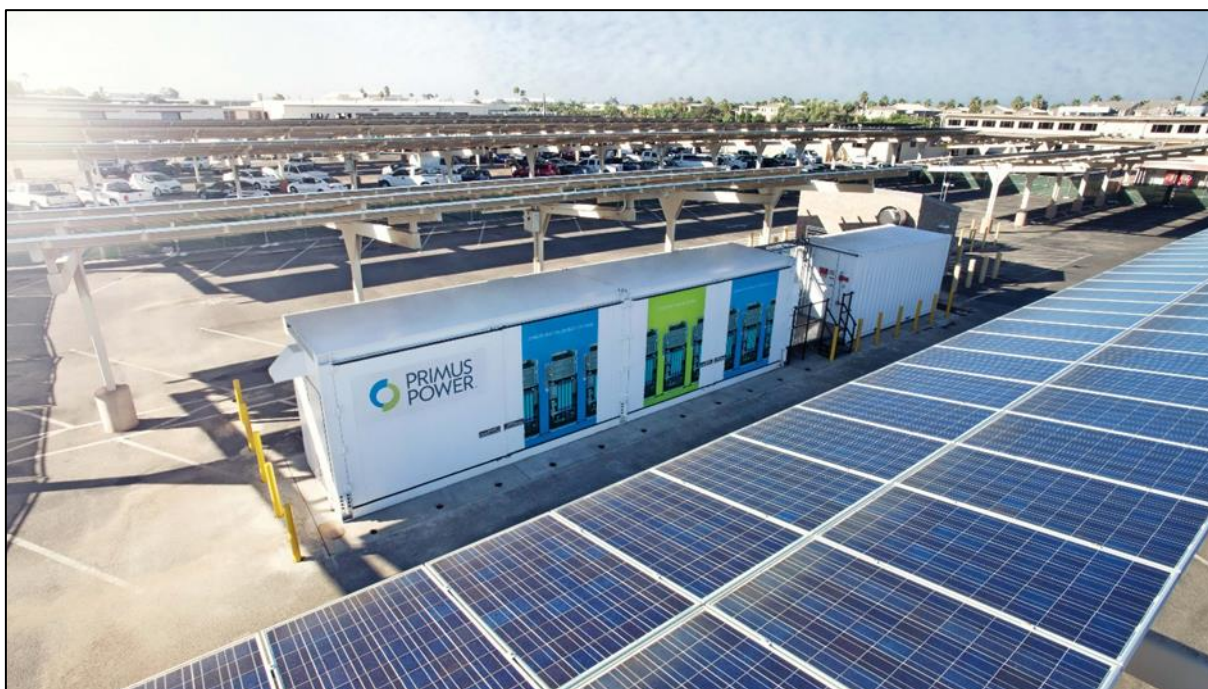
Obrázek 11: Instalace 250 kW zinek-bromidového bateriového systému v San Diegu v USA.
